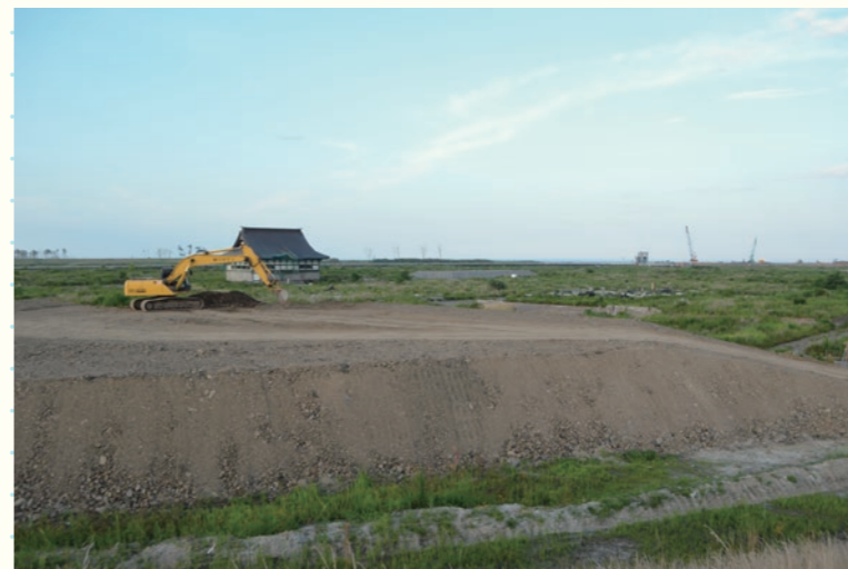
開上の盛り土／Yuriage's embankment 2014年8月5日／August 5, 2014 宮城県名取市／Natori, Miyagi まちづくり部／Machizukuri-bu (Community Building Club)
